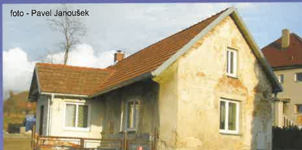
foto před opravou
