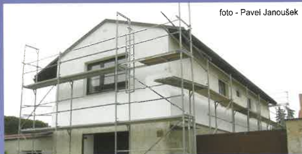
foto před opravou
